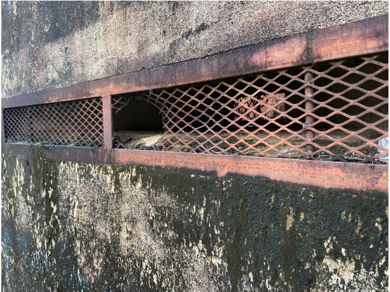
Détail d'une bouche à feu grillagée, depuis la cour des prévenus vers le couloir central, état en mai 2026.
