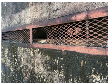
Détail d'une bouche à feu grillagée, depuis la cour des prévenus vers le couloir central, état en mai 2026. Phot. Lionel Besnard IVR03_202697300077NUCA
