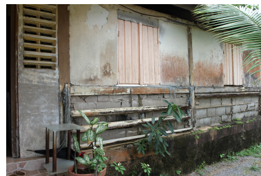
Détail de la façade postérieure où des parpaings remplacent les lames ventilantes, état en 2016 Phot. Kristen Sarge IVR03_202697300195NUCA
