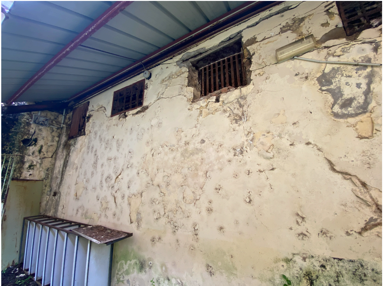
Arrière des dortoirs des condamnés primaires, détail de la maçonnerie de briques enduite témoignant de l'ancienneté de la construction
