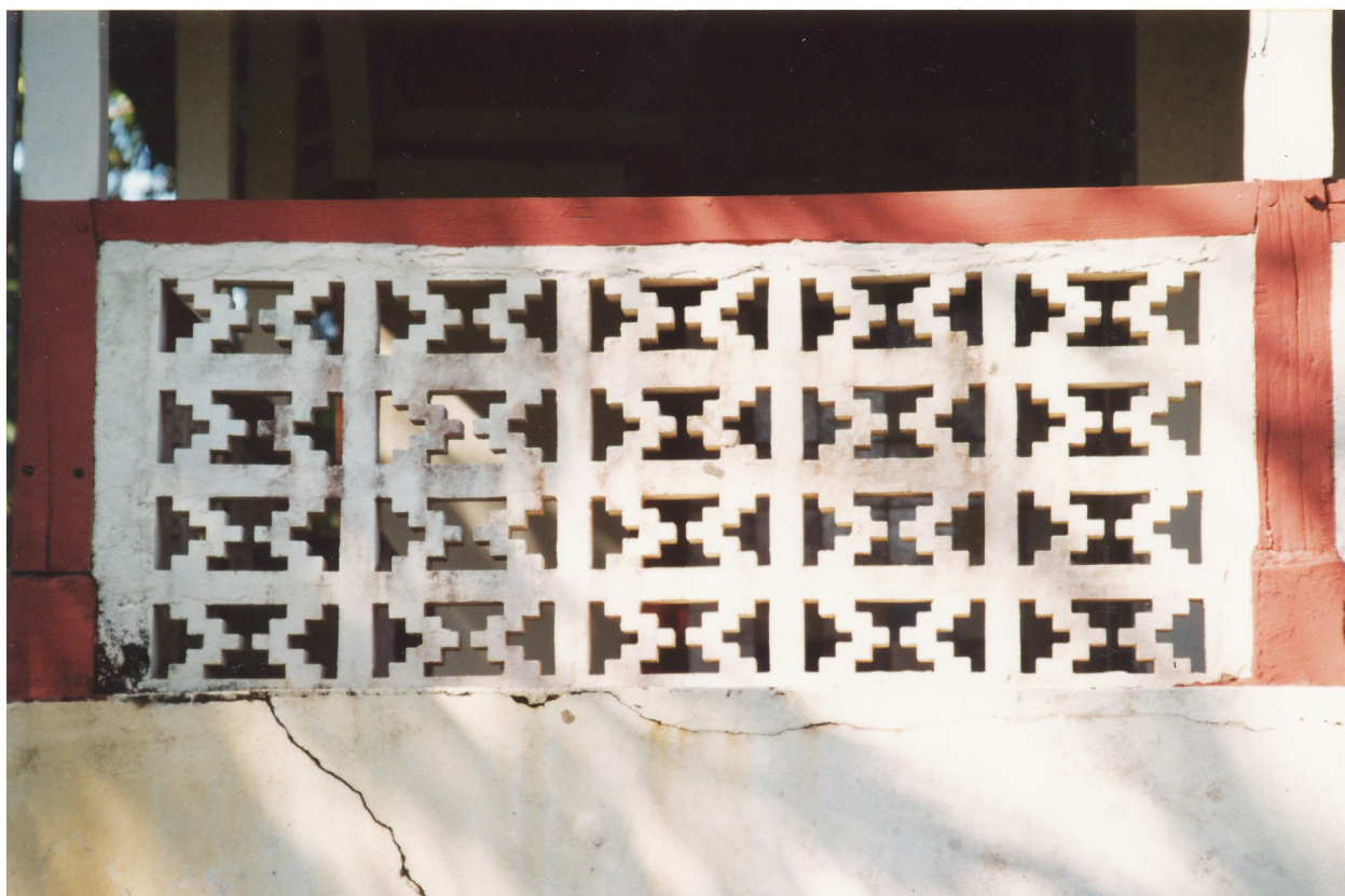
Le garde-corps de la galerie : détail, état en 2002
