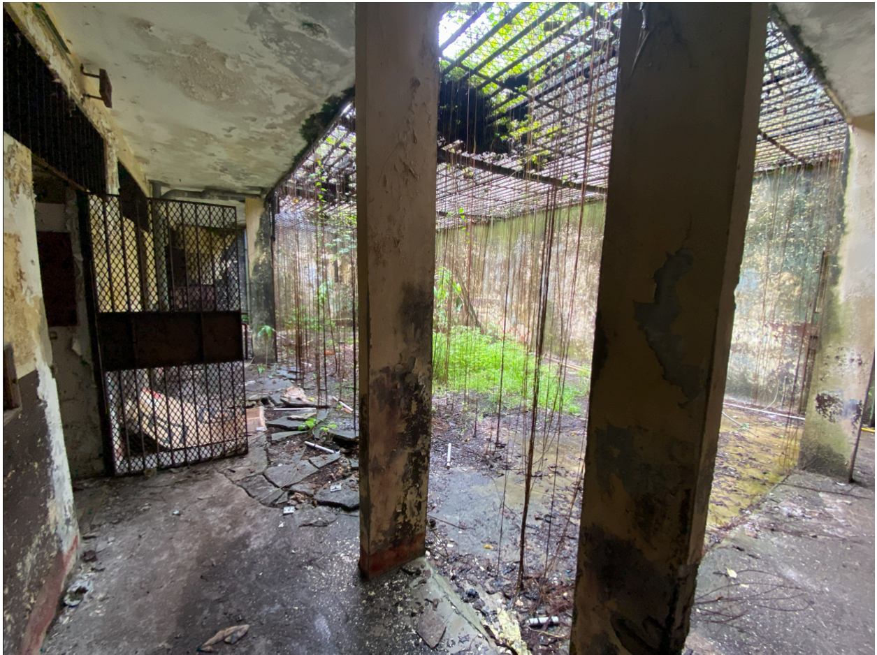
Angle nord-est de l'enceinte, quartier des mineurs, vue de la cour, état en mai 2026.
