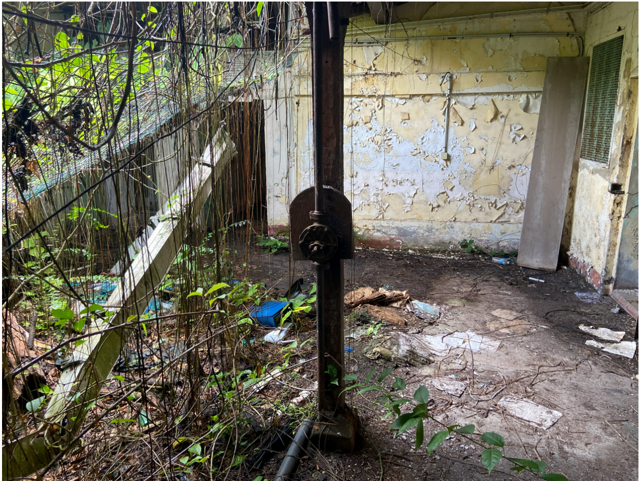
Quartier des femmes, détail de la pompe à eau Japy, état en mai 2026.
